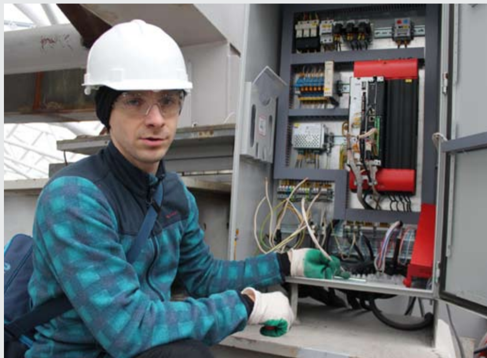
На фото: начальник электролаборатории ООО «ВЦПТ СМК» Александр Пилипчук осуществляет испытание изоляции кабелей питания двигателей тележки раздвижной крыши. Всего на крыше расположено 28 тележек. На момент нашего разговора Александру осталось проверить работу 10 тележек.
