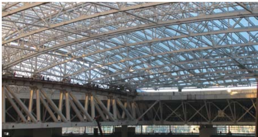
Подпись к фото: Несмотря на молодость, у Вячеслава Волкова достаточный опыт выполнения верхолазных работ; пилоны стадиона имеют надежное заземление.
